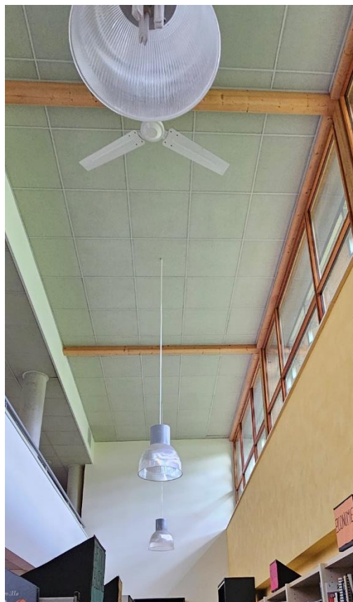
Figure 14: Centre de ressources / lustres - ampoules à remplacer
