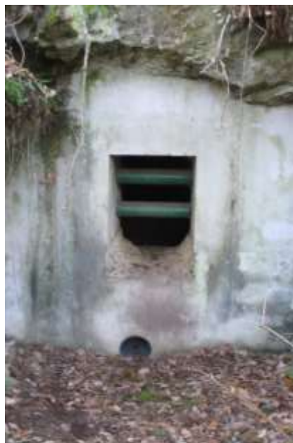
Sécurisation avec barreaux et dégradations du béton par vandalisme (© CEN Auvergne)
